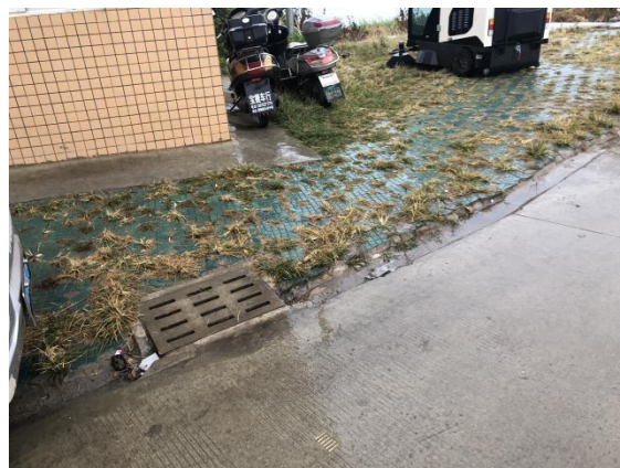
照片 18 项目周边雨水管网
