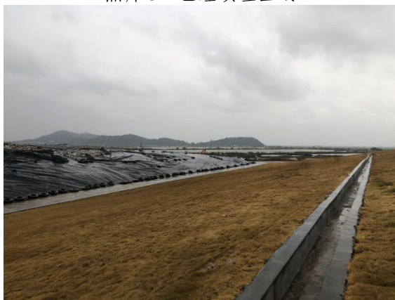
照片 5 项目内排水沟
